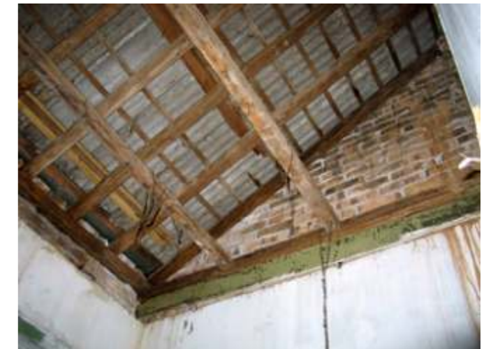
TELHADO PRIMEIRO VOLUME A estrutura de madeira e as telhas não são originais. Algumas peças estão em condições de serem aproveitadas, pelo menos em parte.
